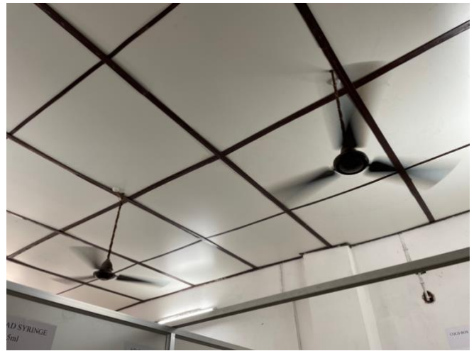
保冷庫を移設した際に JCV の支援で修理した天井
